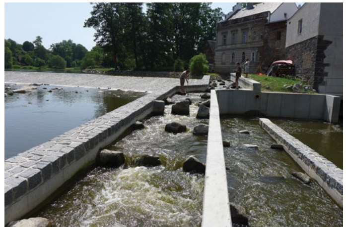
Obr. 6. Rybí přechod, postavený současně s rekonstrukcí jezu v Podělusích; snímek zachycuje měření, prováděná v roce 2019 ku zjištění hydraulické účinnosti objektu. Výstavba přechodu byla dotována v rámci operačního programu Životní prostředí (foto T. Just)
