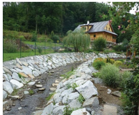
Rekonstrukce opevnění Chotoušského potoka ve městě Jílové u Prahy, místní část Borek. Koryto bylo opevněno kamennou rovnáninou v zastavěné části obce
