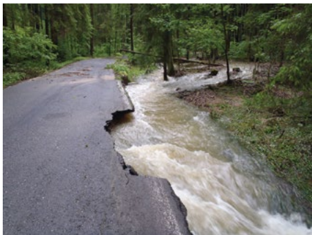
Přítoky Úžického potoka kompletně zanesly propustky na silnici Sázava-Úžice, kterou bylo nutné kompletně rekonstruovat
