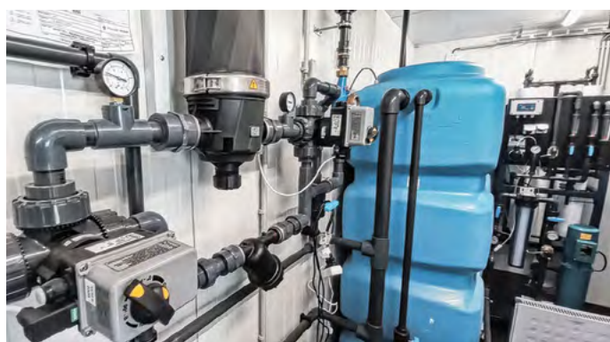
Pohled na část technologie odstraňování PFAS látek
