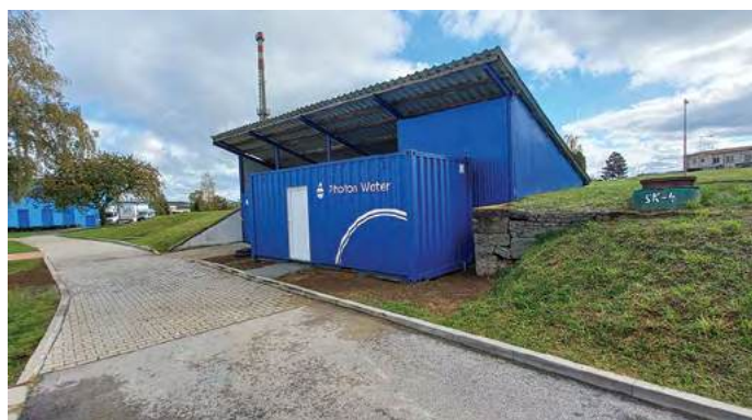
Pohled na kontejnerovou recyklační technologii
