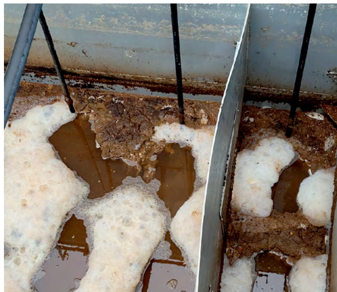
Akumulační nádrž ČOV-systém SBR
