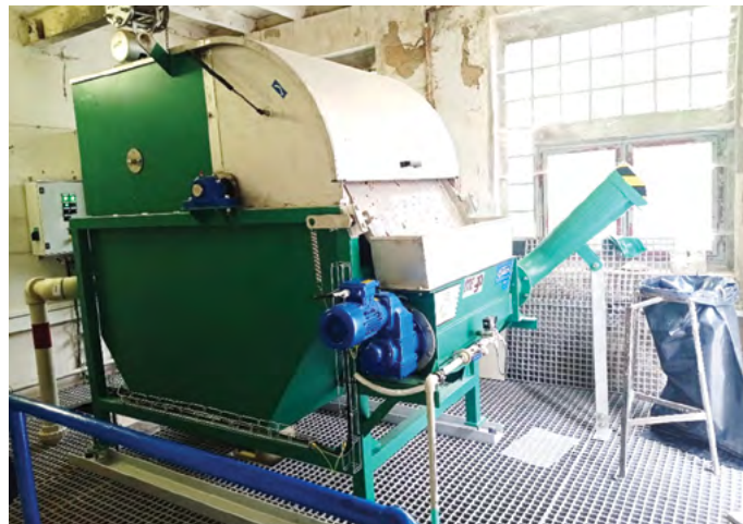
Obr. 2b. Reálné provedení instalace
