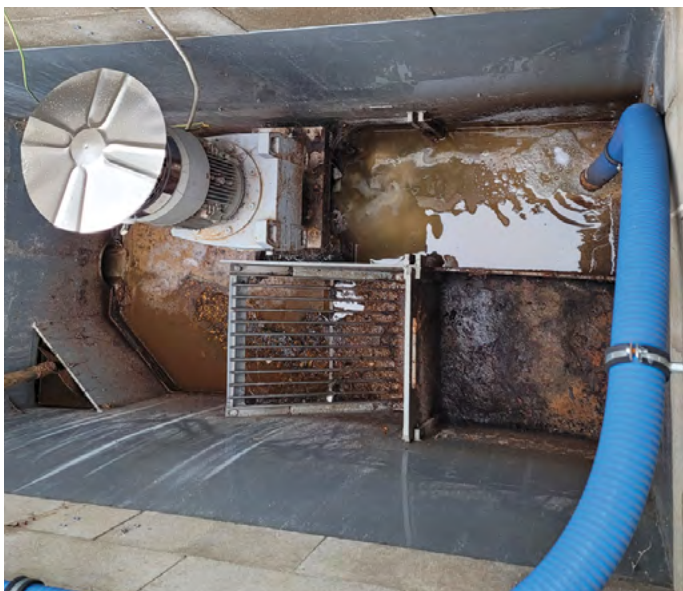
Pohled na nátok na ČOV s drtičem shrabků
