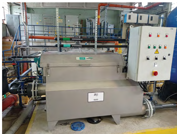
Obr. 4. Realizace – mikrosítový bubnový filtr 10 μm
