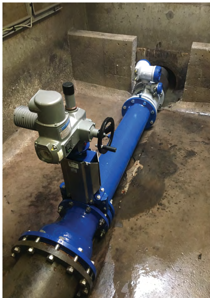
TIDALFLUX 2300 F jako součást zařízení pro regulaci dešťové kanalizace s šoupátkem a ventilem
